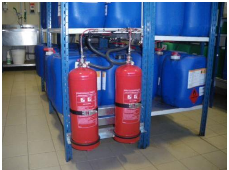
Rack de stockage
